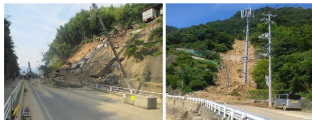
写真-2 県道 279 号が通行止めとなったもたれ擁壁崩壊(左・ 図-2 中番号 1)と斜面災害(右・ 図-2 中番号 2)
